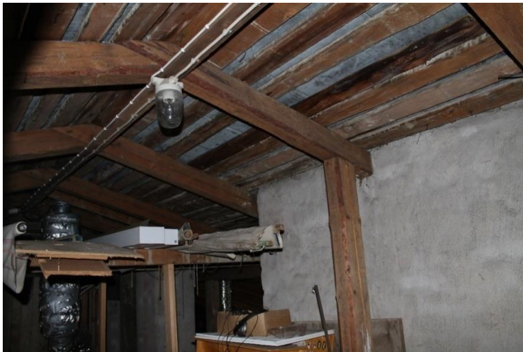
Kuva 306 Ullakon kattorakenteita. Vesikatteella ei ole lainkaan aluskatetta.
