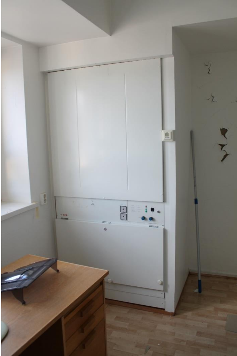
Kuva 235 Keittiössä sijaitsee rakennuksen lämmitysjärjestelmään liittyvää tekniikkaa.
