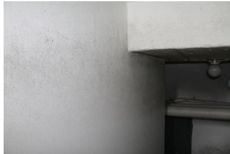
Kuva 283 Kellarin seinät ovat tummuneet porrashuoneessa.
