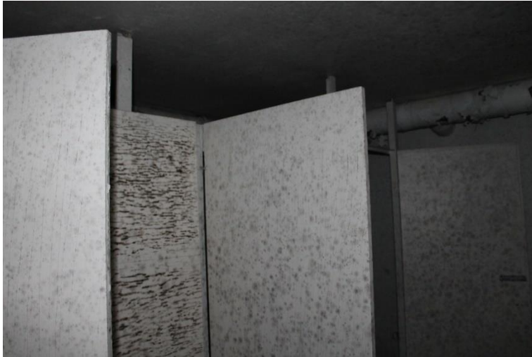
Kuva 280 Vessakoppien seinät ovat tummuneet.
