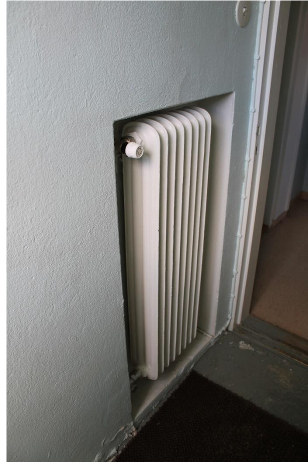
Kuva 115 Seinän sisään lovettu lämpöpatteri tuulikaapissa.
