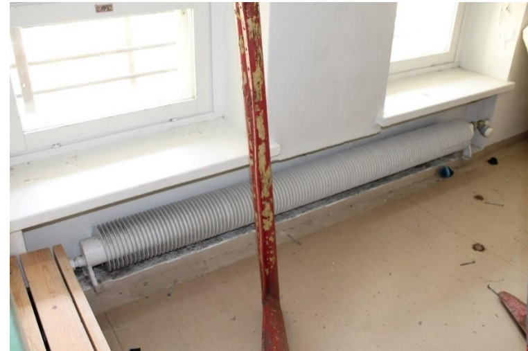
Kuva 165 Käytävällä sijaitsevan vaateilan yhteydessä on sylinterimäinen lämpöpatteri.
