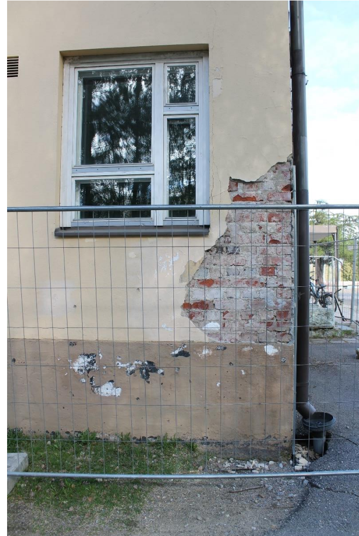
Kuva 53 Julkisivun rappaus on paikoin rapistunut. Alta näkyy tiiliseinä.
