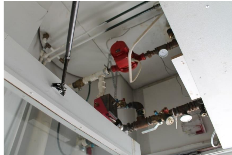
Kuva 90 Tuulikaapin katossa on näkyvillä vesijohtoja ja muuta tekniikkaa.
