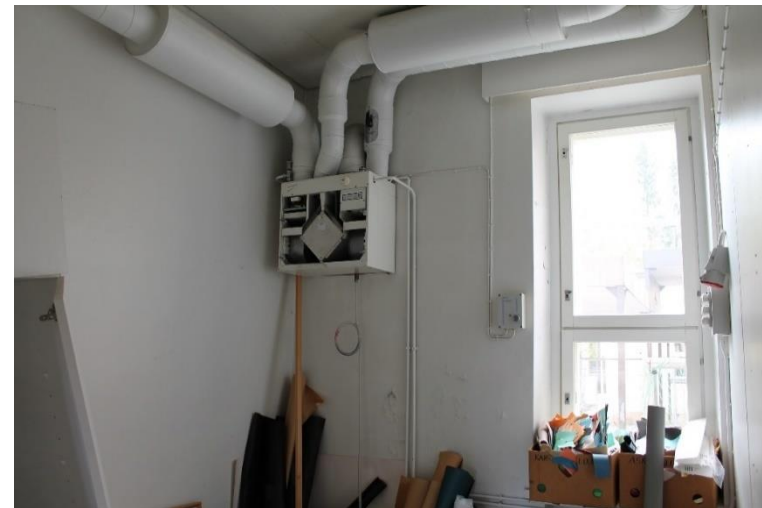
Kuva 181 Ilmanvaihtotekniikkaa luoteen puoleisen siipiosan varastotilassa 120.
