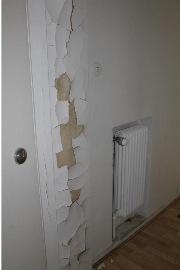
Kuva 243 Yläkerran pintamaalit ovat rapistuneet.
