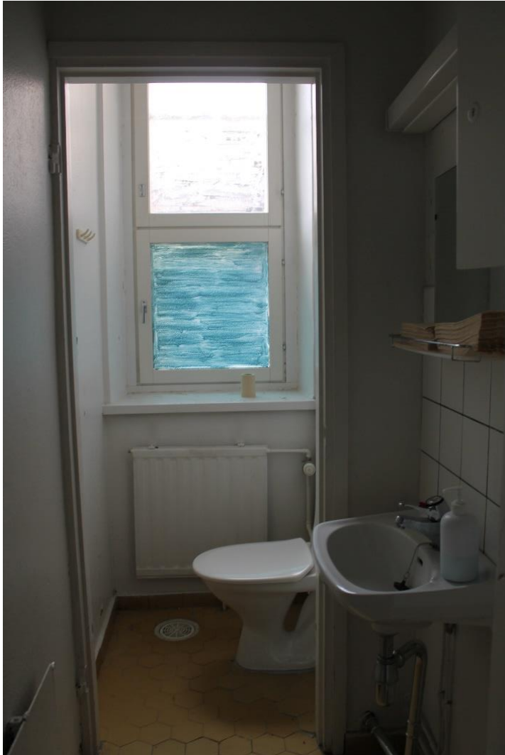
Kuva 176 WC-tilan ikkuna on peitetty maalaamalla se umpeen.
