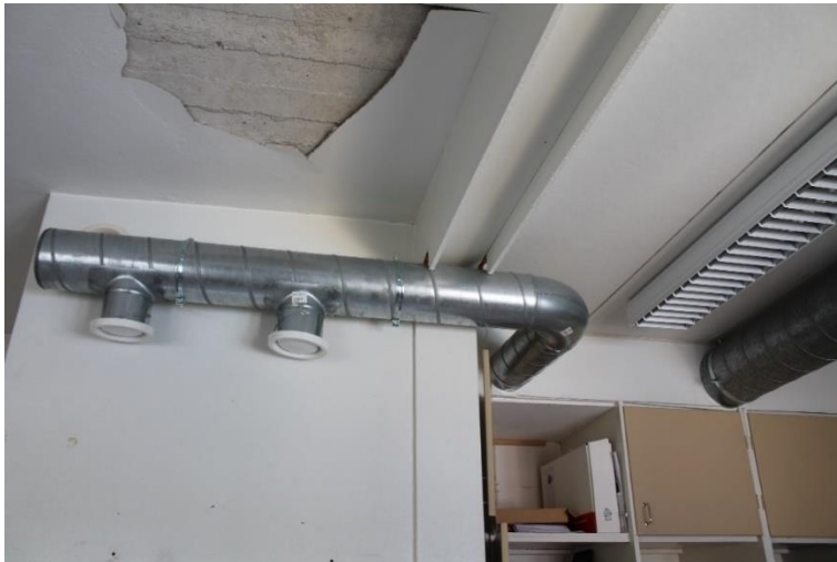
Kuva 212 Ilmanvaihtoputkia opettajainhuoneessa. Kuvan vasemmassa yläreunassa näkyy betonista yläpohjalaattaa.
