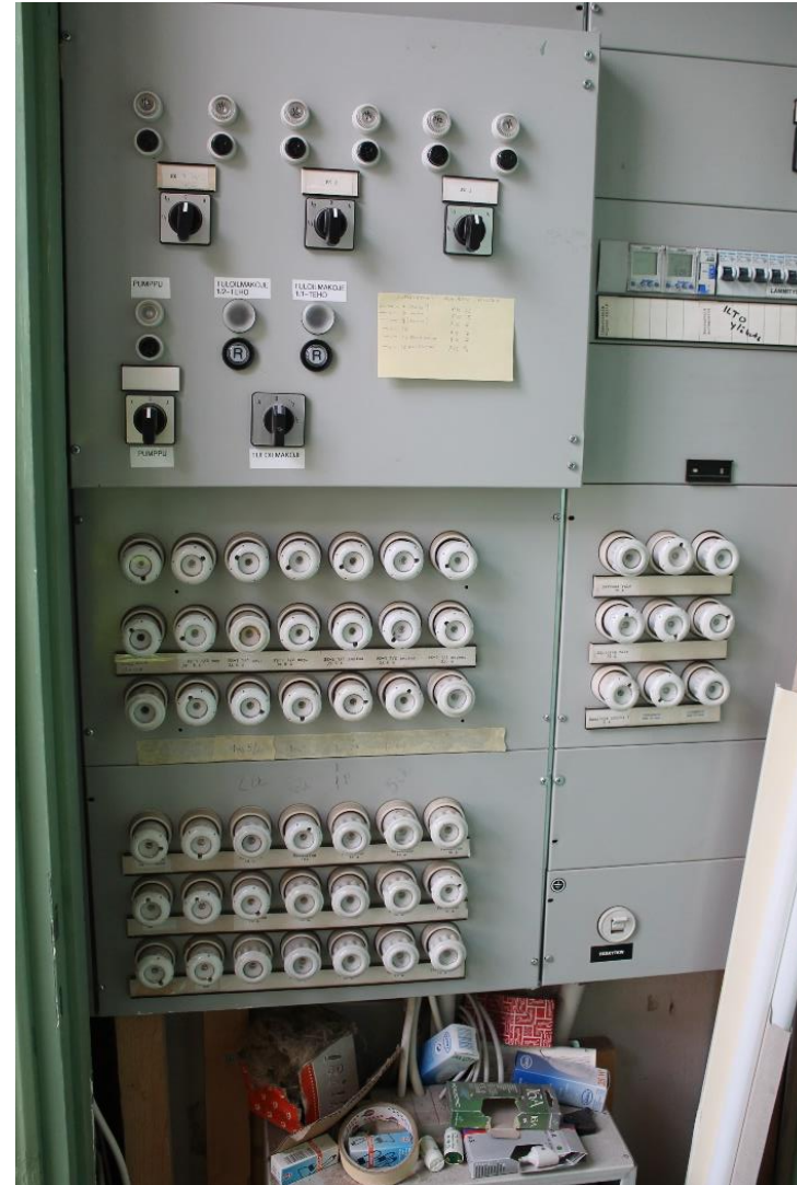
Kuva 168 Sähköpääkeskuskomerossa sijaitseva ryhmäkeskus.
