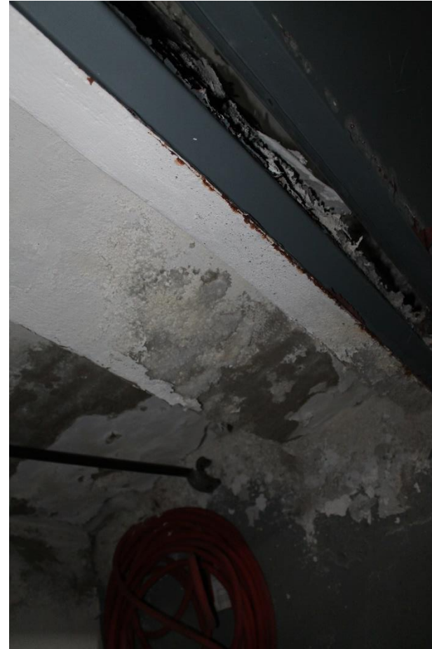
Kuva 287 Mikrobikasvustoa kellarin seinässä.
