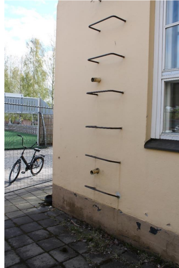
Kuva 70 Hätäpoistumistien tikkaat julkisivulla.
