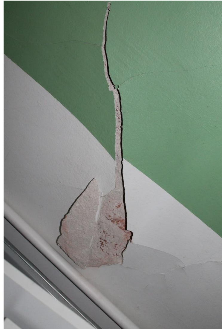
Kuva 170 Käytävän seinän maalipintaa.
