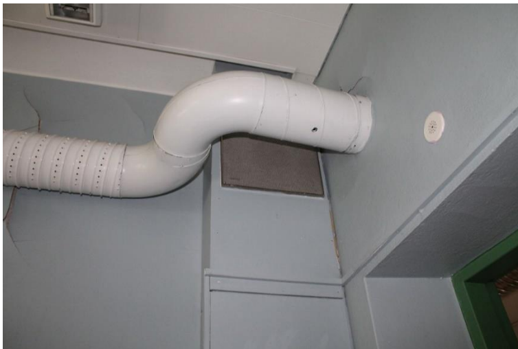
Kuva 123 Rakennuksen sisäkatoissa on esillä monenlaisia ilmanvaihtoputkia.
