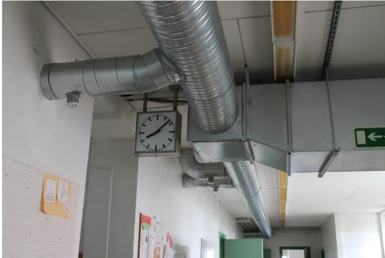
Kuva 169 Ensimmäisen kerroksen käytävällä roikkuva kello ja talotekniikan putkia.
