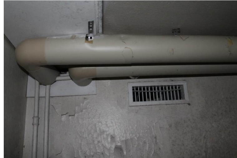
Kuva 269 Ilmanottoaukko ja eristetty putkikanavia.
