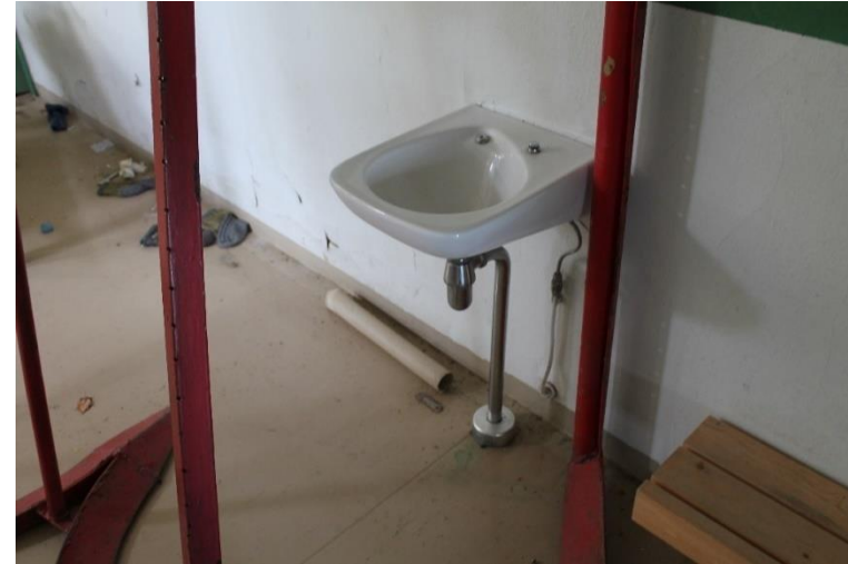
Kuva 164 Käytävällä sijaitseva vesipiste.
