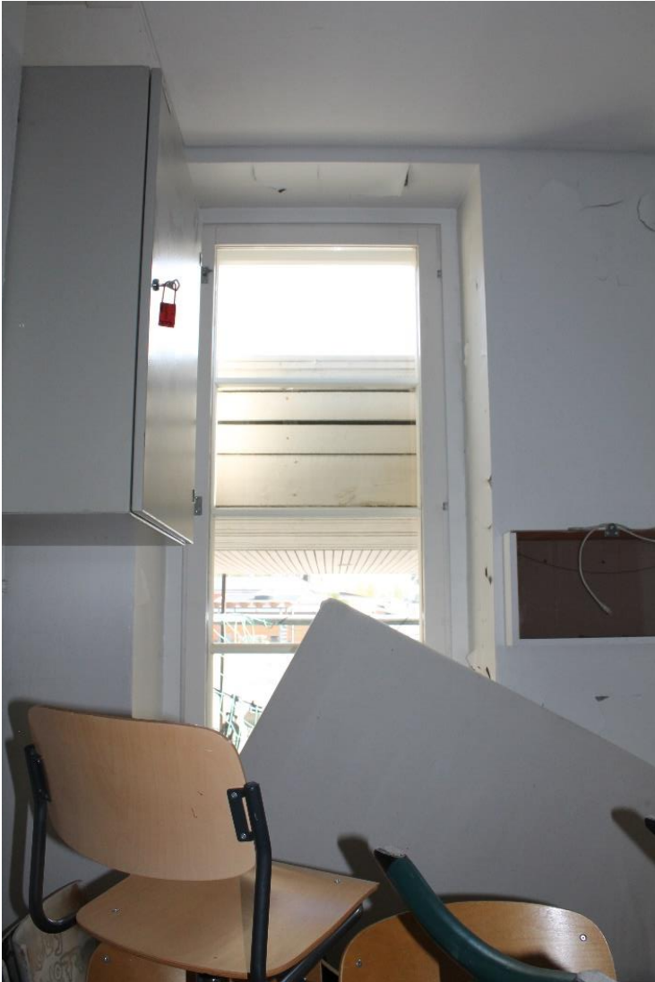
Kuva 96 Käytävällä on korkeat ikkunat koilliseen pihalle päin. Sisäpihalla sijaitsevien kellarinportaiden päälle rakennetut katoksen peittävät suuren osan käytävän ikkuna-aukoista.
