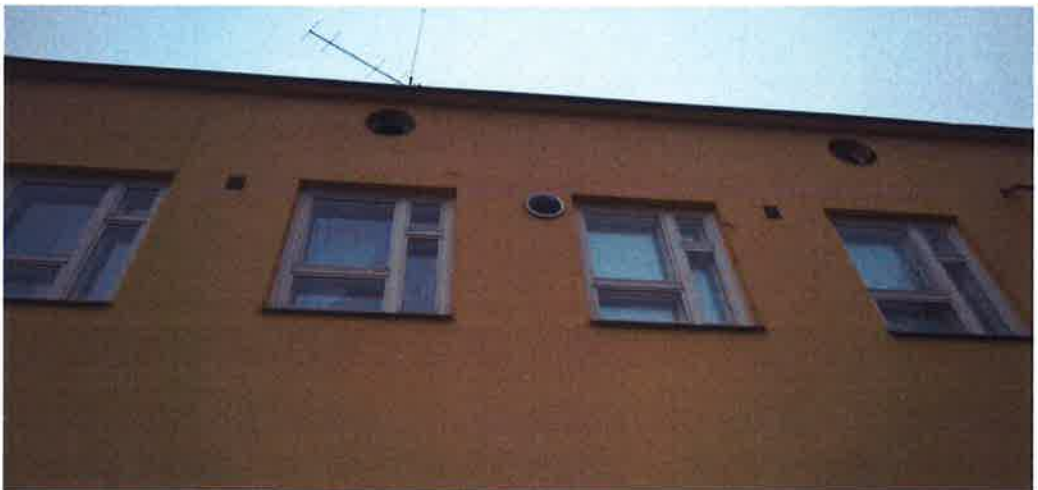
Kuva 9. Lyhyet räystäät eivät suojaa julkisivua sateelta.
