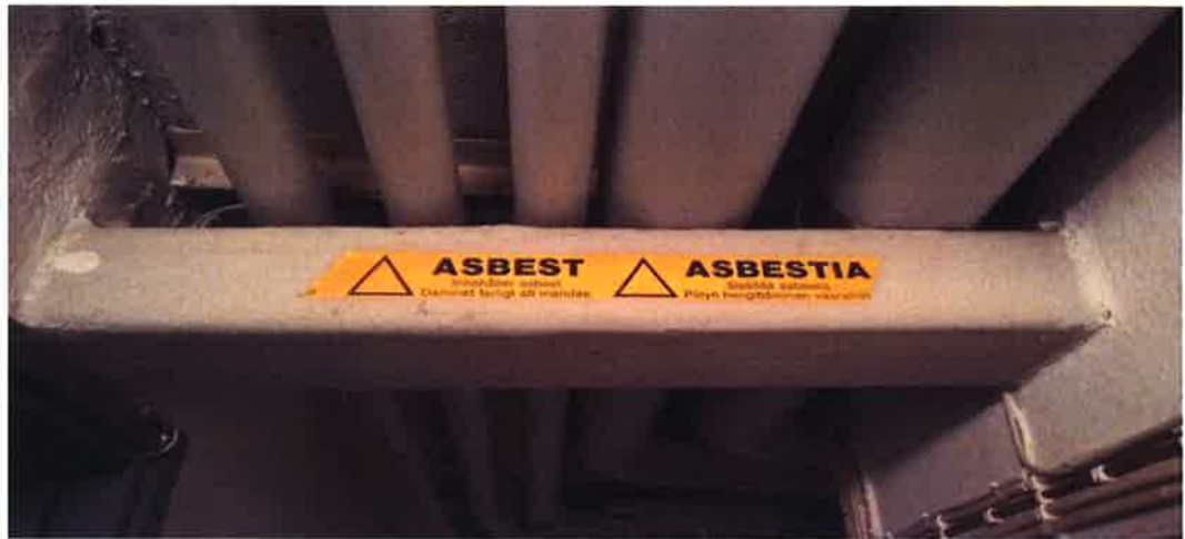
Kuva 11. Kellarissa on asbestilevyrakenteisia iv-kanavia
