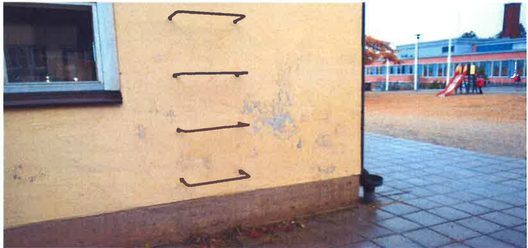
Kuva 4. Maali hilseilee irti seinäpinnoilta. Sokkelit ovat märät.
