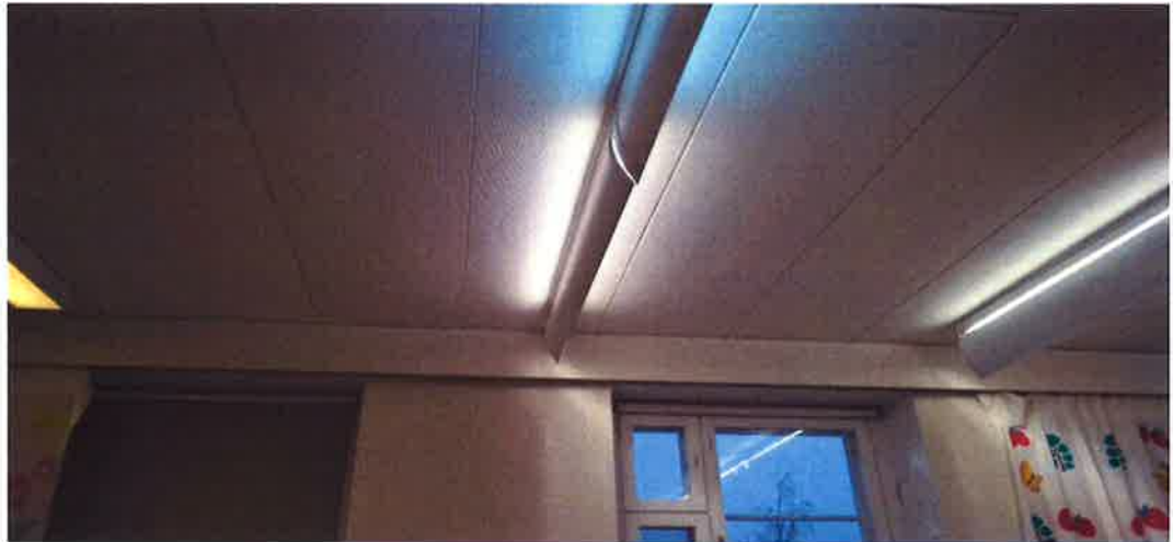
Kuva 14. Katoissa on paikoin vuotojen aiheuttamia jälkiä.
