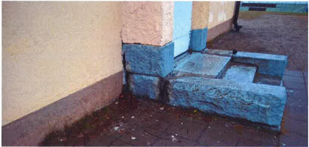
Kuva 7. Oikean sivun sisäänkäynnin portaat ovat painuneet.
