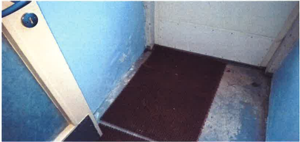
Kuva 17. Seinäpinnat kupruilevat paikoin kosteuden vaikutuksesta. Maali hilseilee irti lattiasta.
