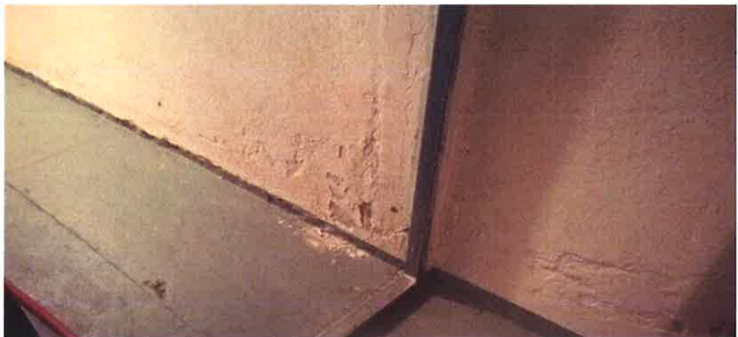
Kuva 10. Kellarin pinnoilla näkyy kosteuden aiheuttamia jälkiä.
