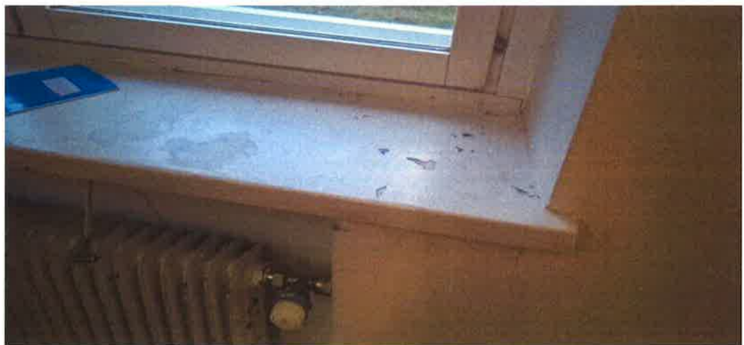
Kuva 18. Ikkunapenkit voivat sisältää asbestia.
