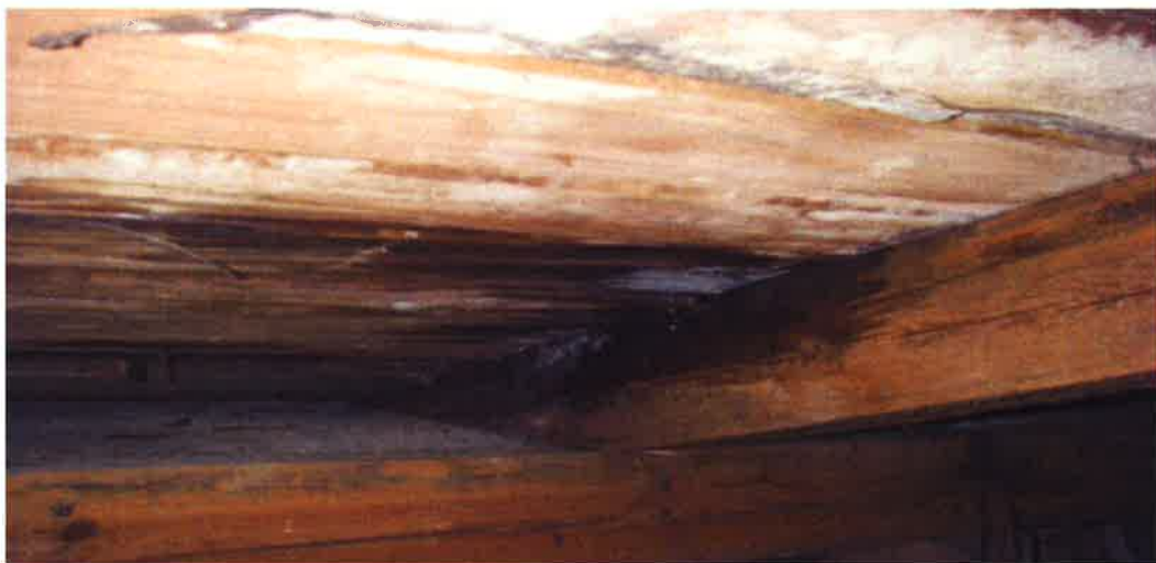
Kuva 20. Korkean osan kattorakenteissa on paikallisia vaurioita.
