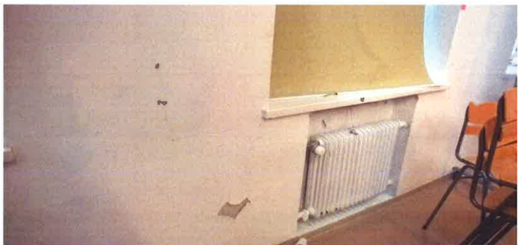
Kuva 16. Seinien sisäpinnat ovat paikoin pahasti rapautuneet.
