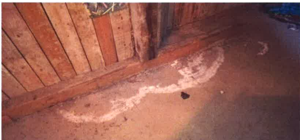
Kuva 21. Korkean osan vintillä olleen kattovuodon aiheuttama kosteusjälki.
