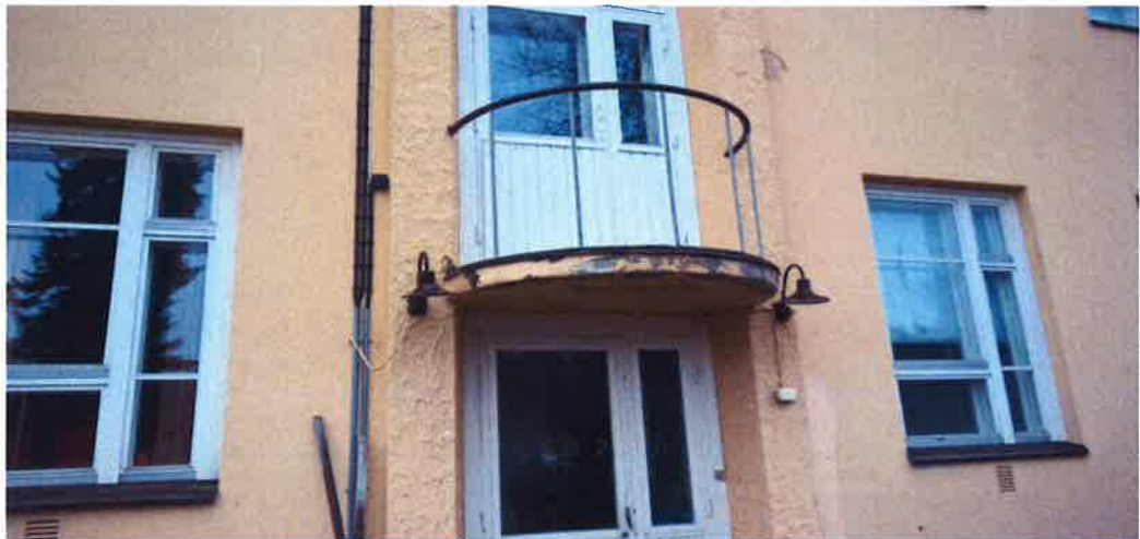
Kuva 2. Parveke on vaarallisen huonokuntoinen.
