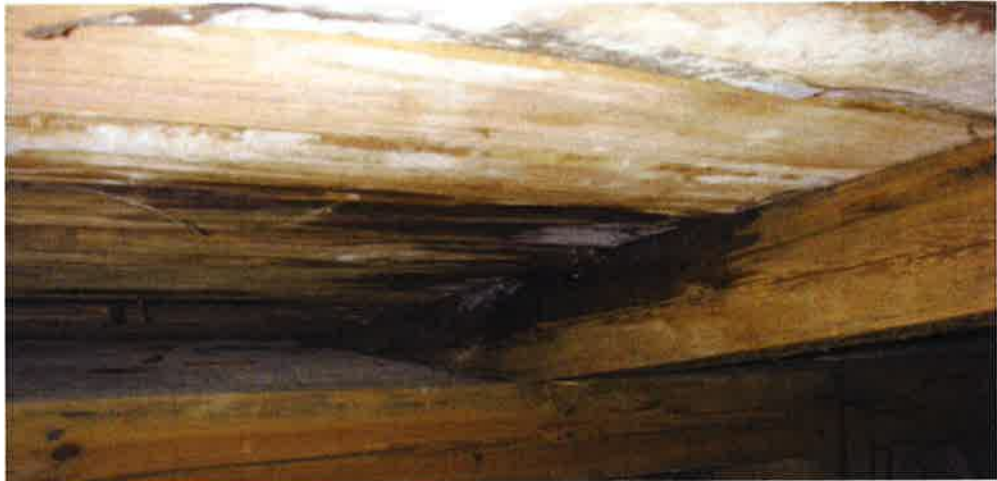
Kuva 20. Korkean osan kattorakenteissa on paikallisia vaurioita.
