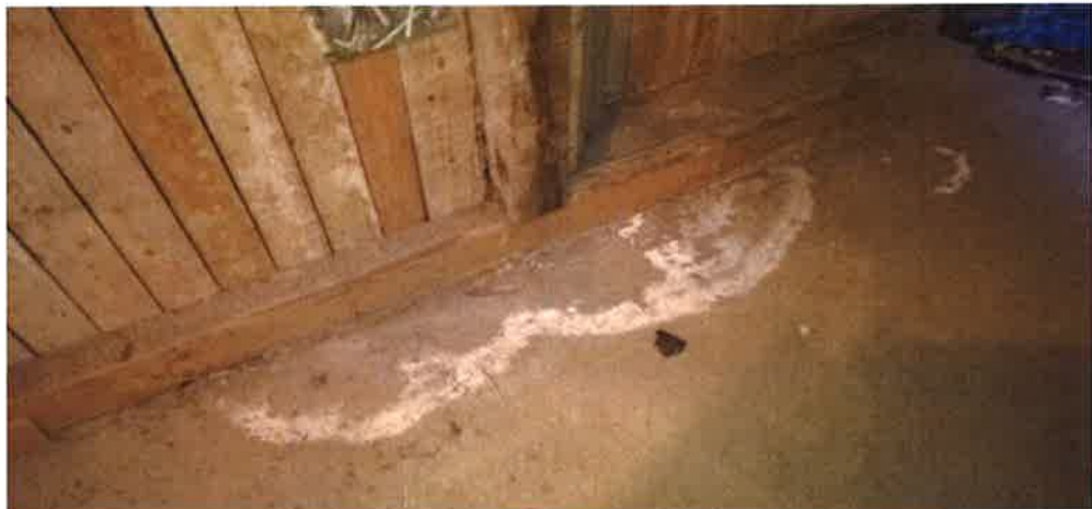
Kuva 21. Korkean osan vintillä olleen kattovuodon aiheuttama kosteusjälki.
