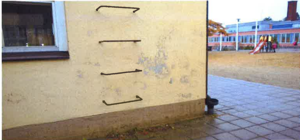
Kuva 4. Maali hilseilee irti seinäpinnoilta. Sokkelit ovat märät.
