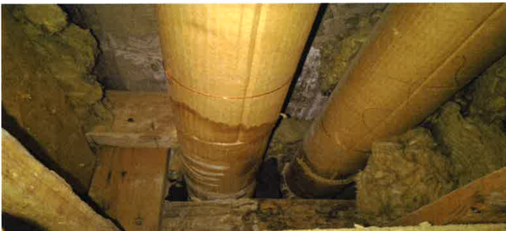
Kuva 13. Kellarissa on pahvipintaisia putkituksia, jotka ovat kastuneet. Myös puurakenteissa on kosteuden aiheuttamia vaurioita ja tummumaa.
