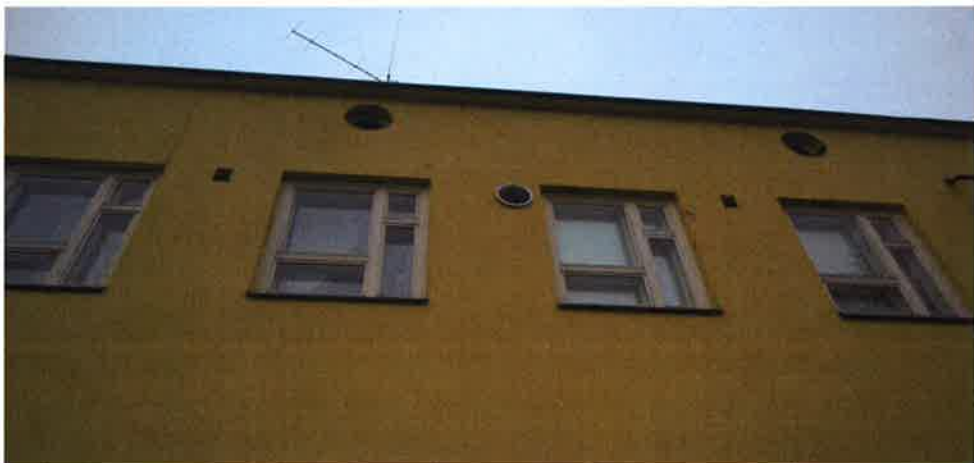
Kuva 9. Lyhyet räystäät eivät suojaa julkisivua sateelta.
