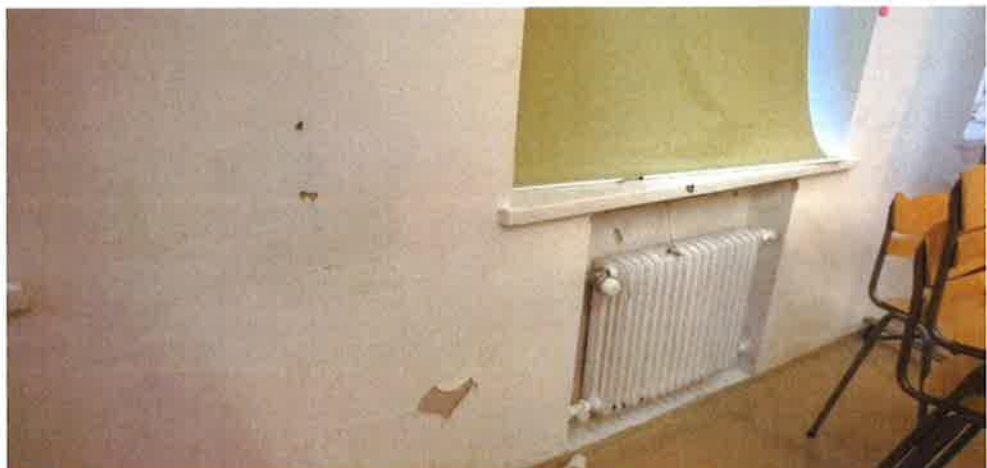
Kuva 16. Seinien sisäpinnat ovat paikoin pahasti rapautuneet.
