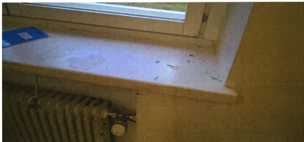
Kuva 18. Ikkunapenkit voivat sisältää asbestia.
