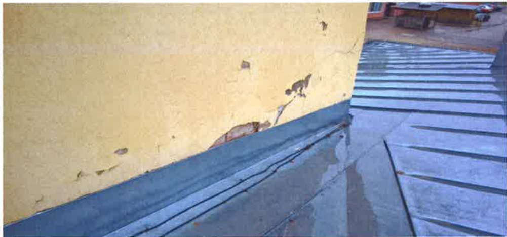
Kuva 23. Matalien osien vesikate on uudenveroinen. Seinäpinnoissa rappaukset irronneet.
