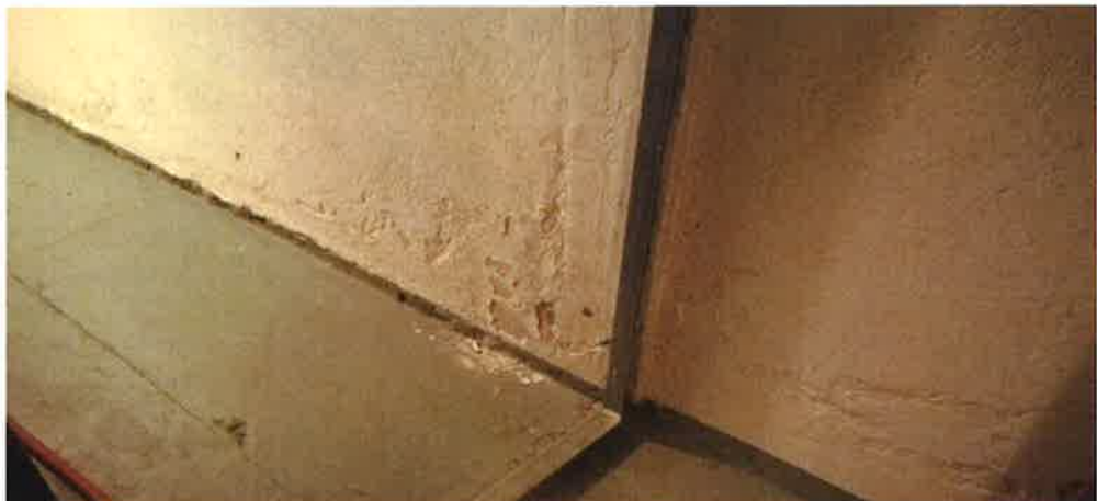
Kuva 10. Kellarin pinnoilla näkyy kosteuden aiheuttamia jälkiä.
