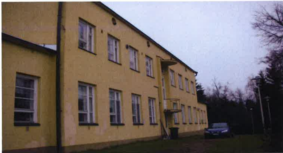
Kuva 1. Ulkoseinärappausta on paikkailtu runsaasti.
