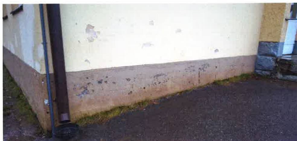
Kuva 3. Sokkeli on paikoin pahasti rapautunut
