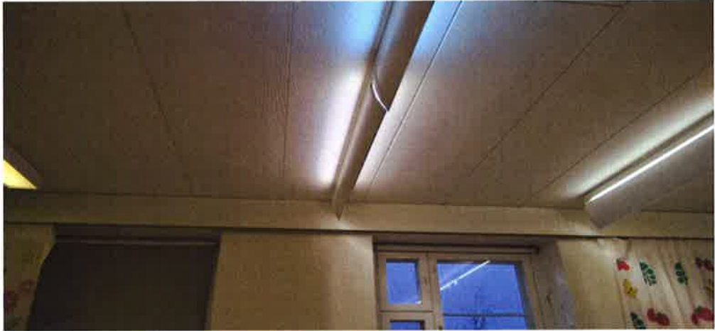
Kuva 14. Katoissa on paikoin vuotojen aiheuttamia jälkiä.
