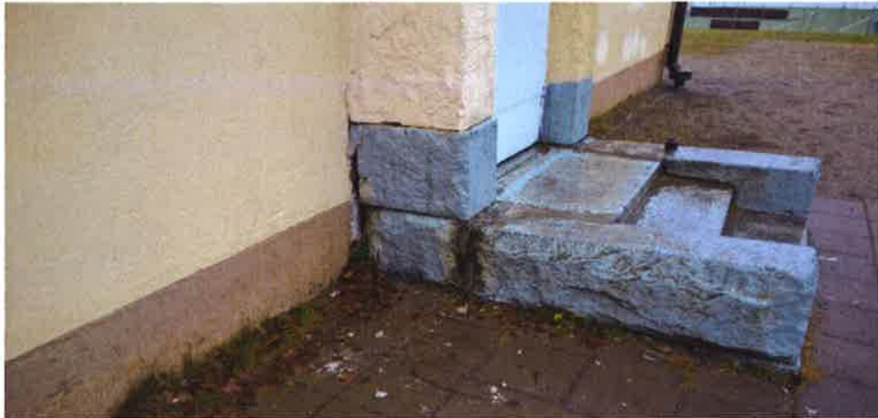
Kuva 7. Oikean sivun sisäänkäynnin portaat ovat painuneet.
