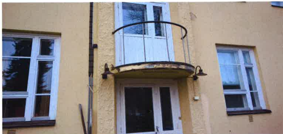
Kuva 2. Parveke on vaarallisen huonokuntoinen.
