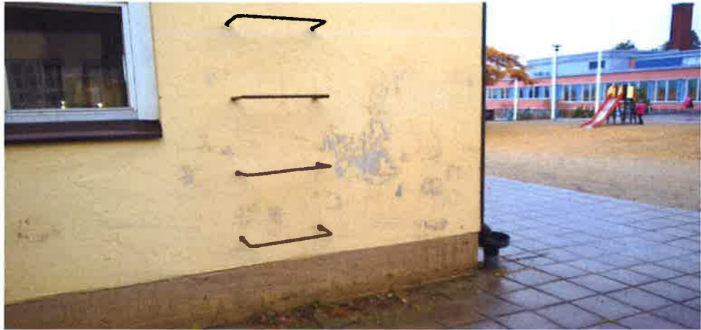
Kuva 4. Maali hilseilee irti seinäpinnoilta. Sokkelit ovat märät.
