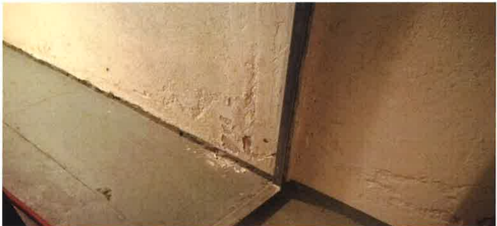
Kuva 10. Kellarin pinnoilla näkyy kosteuden aiheuttamia jälkiä.
