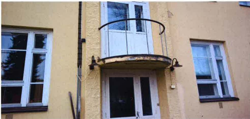
Kuva 2. Parveke on vaarallisen huonokuntoinen.
