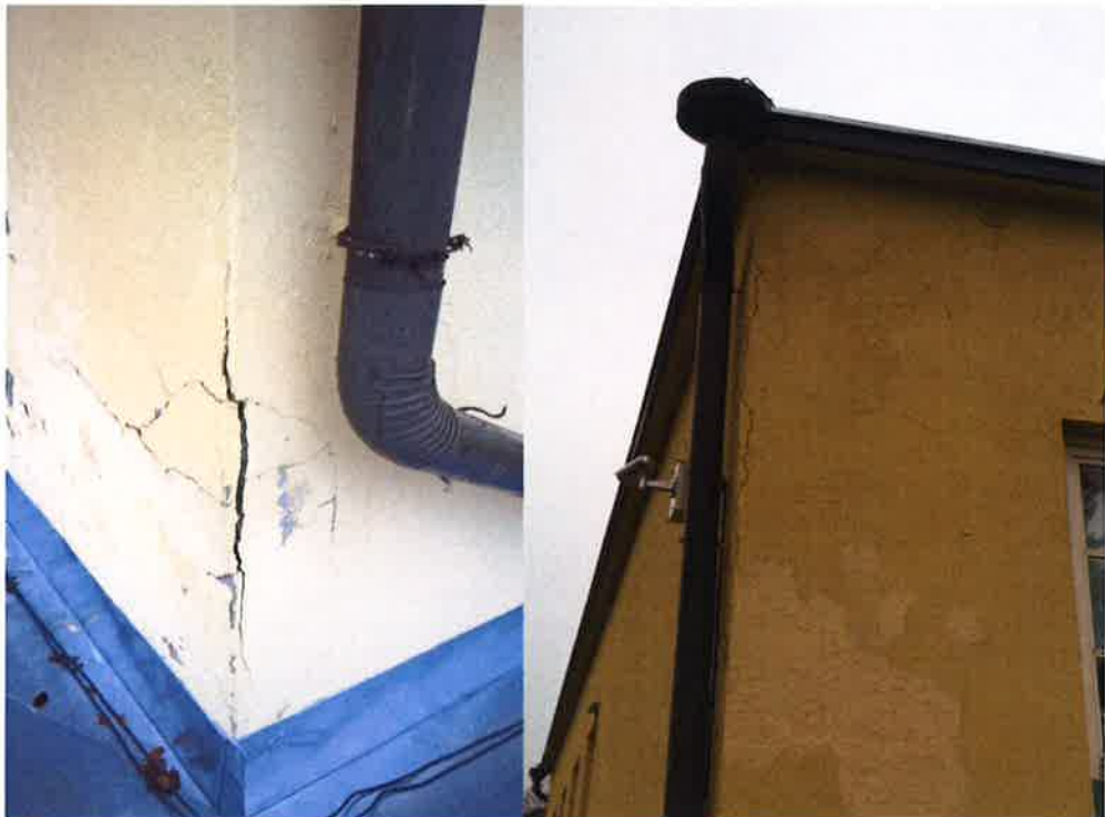
Kuvat 5 ja 6. Rappauspinnassa on paikoin pahoja halkeamia. Rappaus on irti alustastaan.
