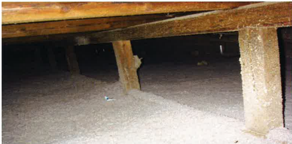
Kuva 19. Matalia katto-osia on lisäeristetty selluvillalla. Kantavat rakenteet on hyväkuntoiset.
