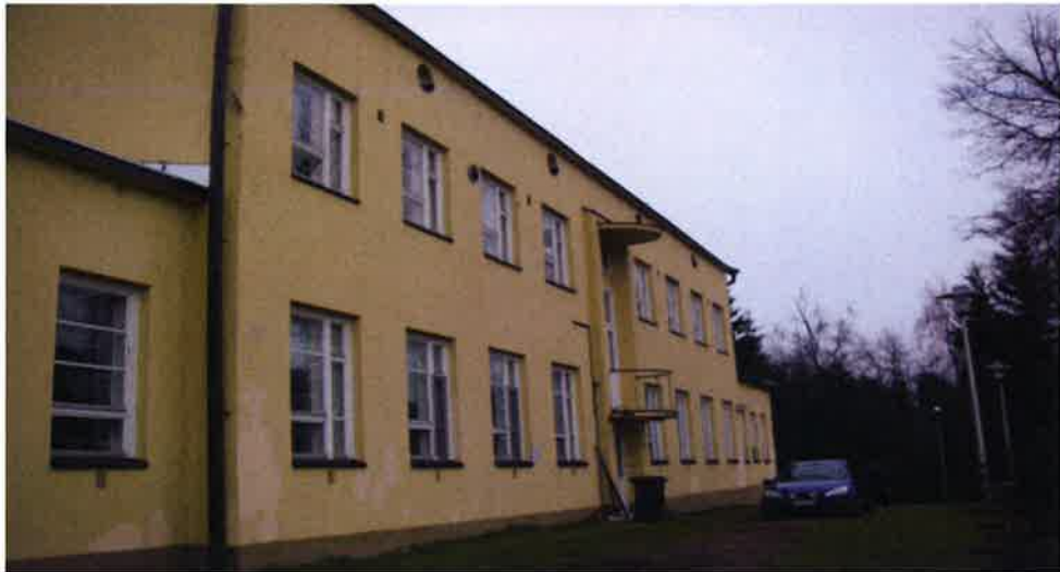
Kuva 1. Ulkoseinärappausta on paikkailtu runsaasti.
