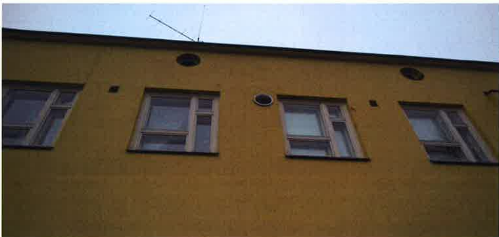
Kuva 9. Lyhyet räystäät eivät suojaa julkisivua sateelta.
