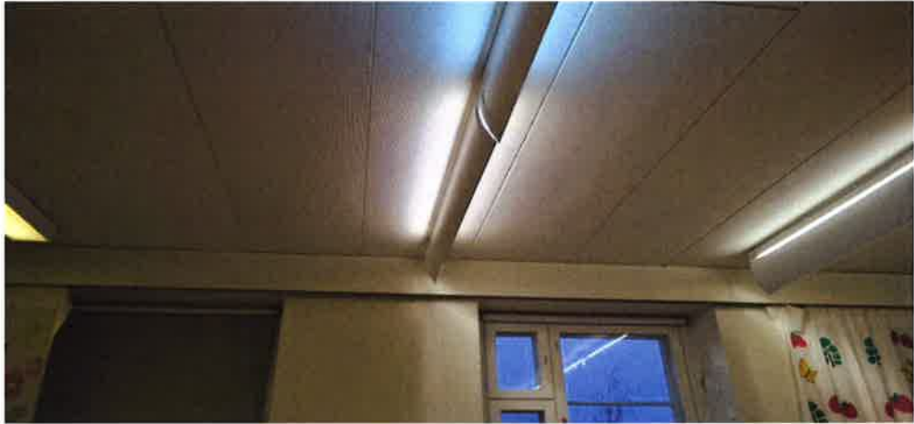
Kuva 14. Katoissa on paikoin vuotojen aiheuttamia jälkiä.
