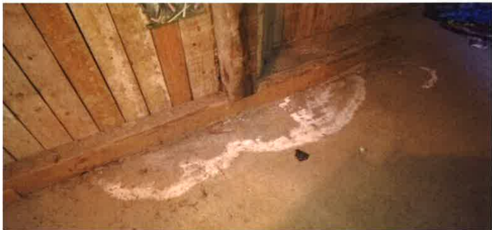
Kuva 21. Korkean osan vintillä olleen kattovuodon aiheuttama kosteusjälki.
