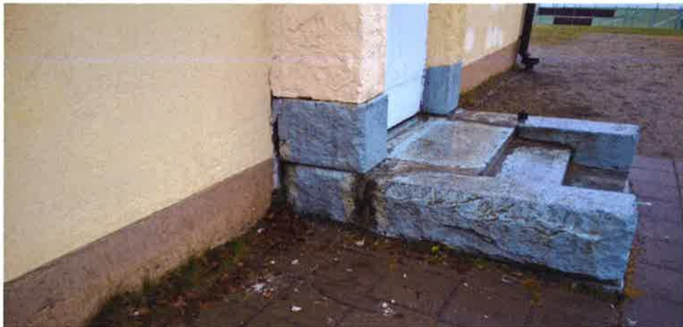
Kuva 7. Oikean sivun sisäänkäynnin portaat ovat painuneet.
