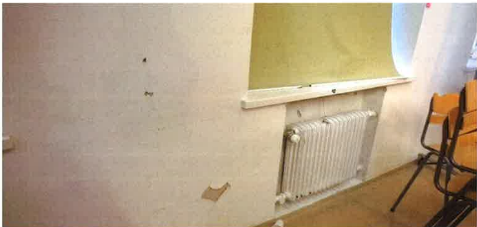
Kuva 16. Seinien sisäpinnat ovat paikoin pahasti rapautuneet.
