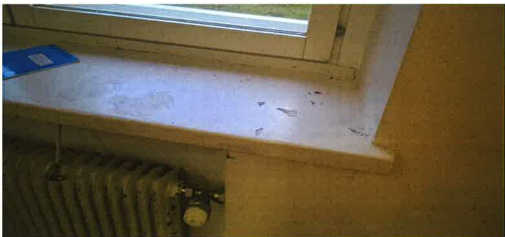
Kuva 18. Ikkunapenkit voivat sisältää asbestia.
