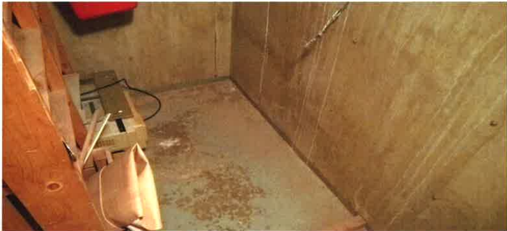
Kuva 12. Kellarissa on levytettyjä pintoja, joissa näkyy runsaasti valumajälkiä.
