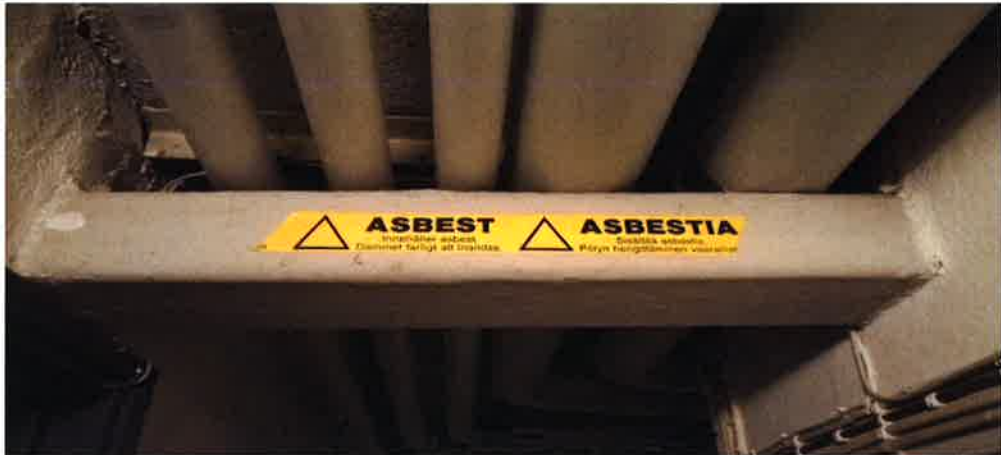
Kuva 11. Kellarissa on asbestilevyrakenteisia iv-kanavia
