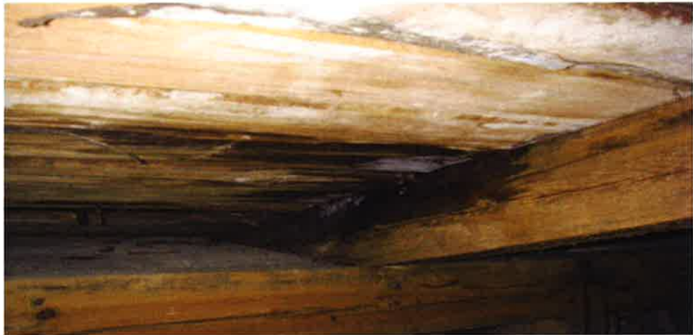
Kuva 20. Korkean osan kattorakenteissa on paikallisia vaurioita.
