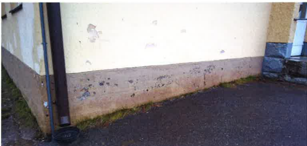
Kuva 3. Sokkeli on paikoin pahasti rapautunut
